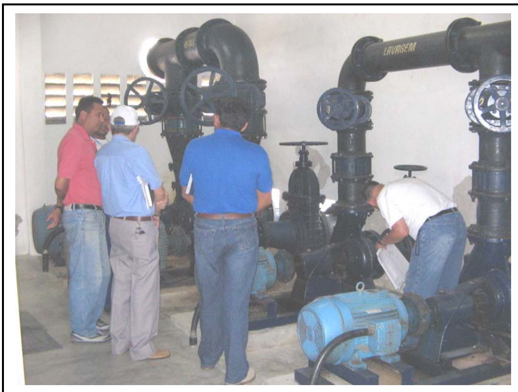
Foto 13 - Outra vista do mesmo equipamento.
