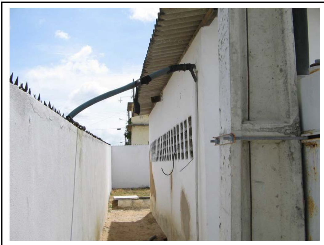
Foto 09 - Reservatório de água tratada.
