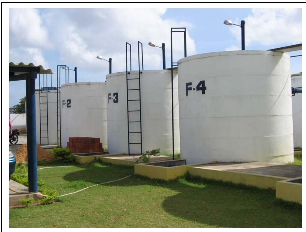
Foto 15 - Vistas dos filtros.
