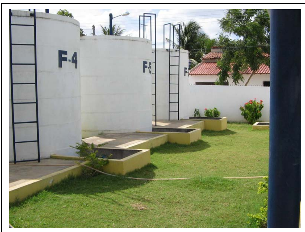
Foto 16 - Vistas dos filtros.
