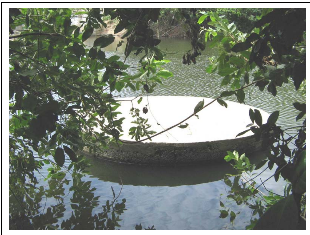
Foto 02 - Poço de captação no leito do rio.
