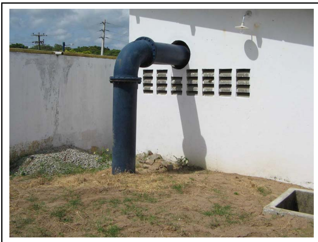
Foto 10 - Estação de bombeamento.
