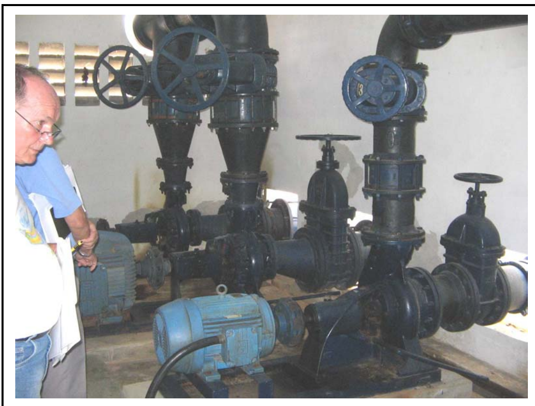
Foto 12 - Vista do conjunto de bombas da EE.
