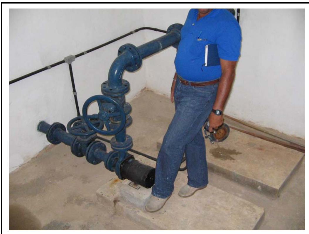
Foto 14 - Booster para pressurização da distribuição próximo à ETA.
